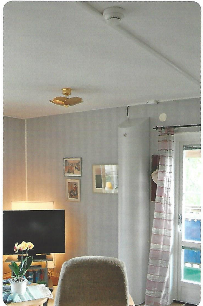
En mobil sprinkler installerad på väggen i vardagsrummet.
